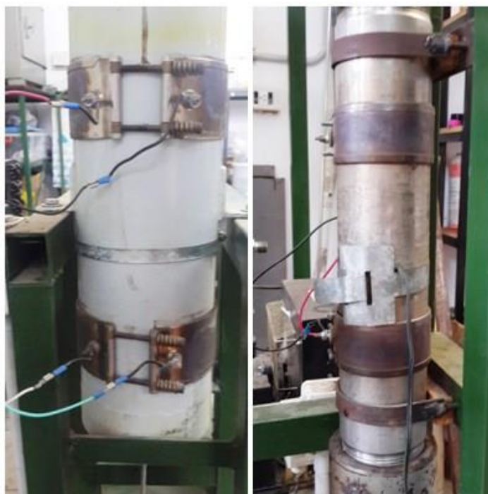
Figura 8.6. Izq: Resistencias calefactores instaladas en el cuerpo del extractor. Der: Resistencias calefactoras instaladas en el cuerpo del separador.
