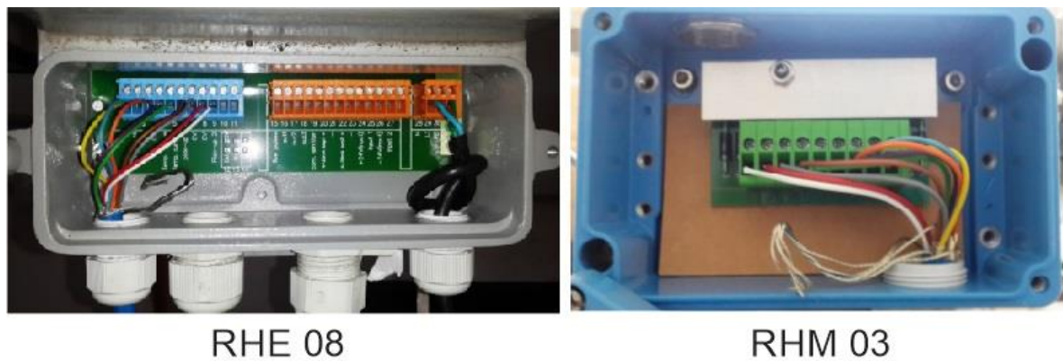
Figura 8.17. Muestra de conexiones. Los cables de colores (9) corresponden al cable de conexión entre los elementos con vaina protectora azul.
