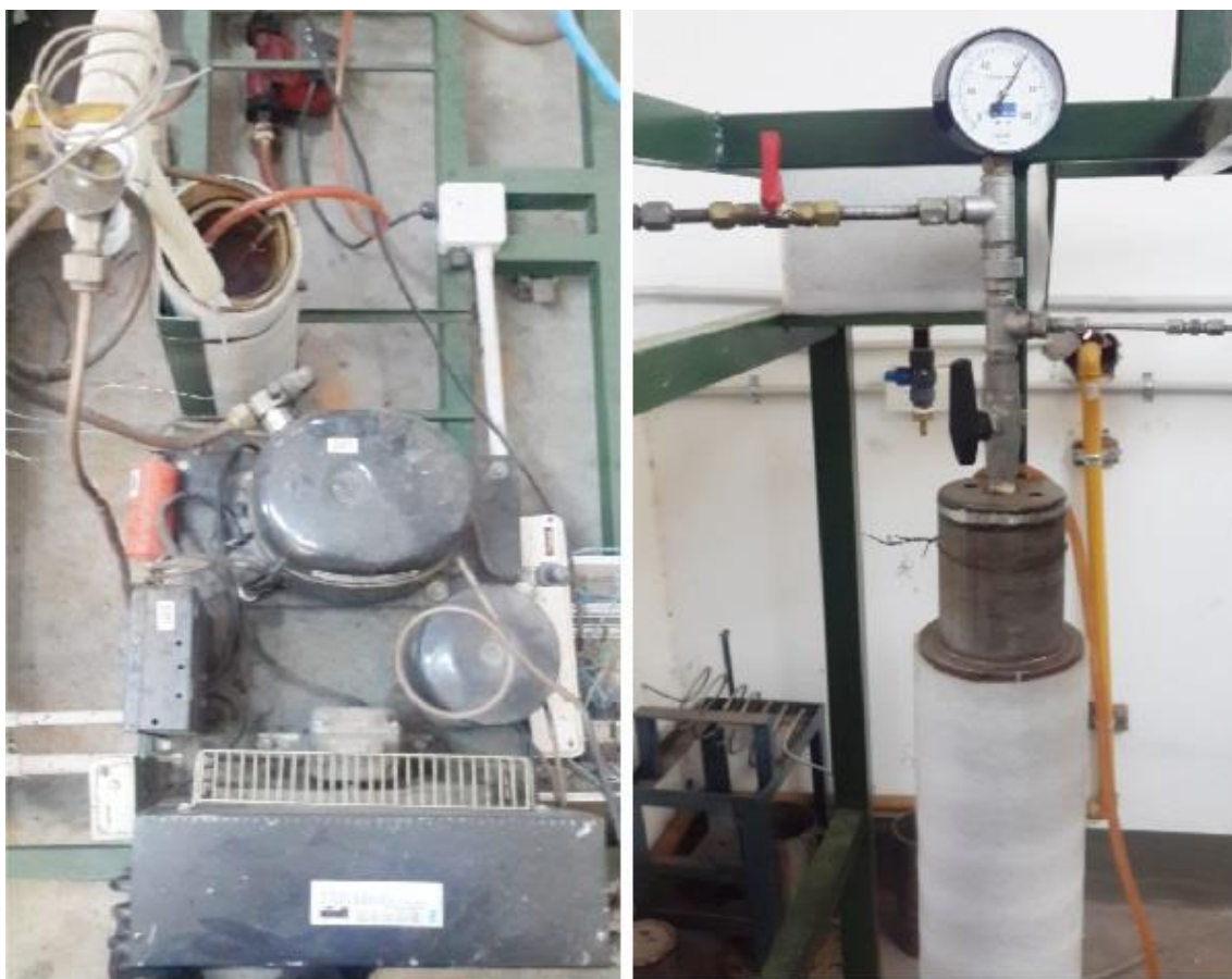
Figura 8.9. Izq: Buffer. Der: Unidad condensadora
