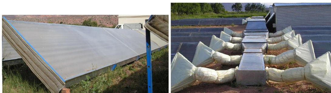
Figura 4. Foto del colector solar calentador de aire. Vista de las campanas de reducción y acople.
