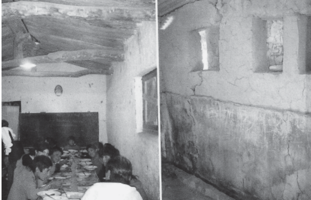
Figura 2. La Escuela de Pascha en la actualidad (comedor y letrinas a demoler).
