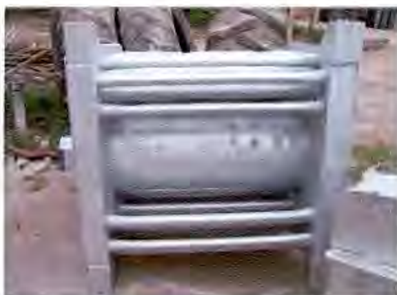
Vista inferior de un intercambiador de calor
