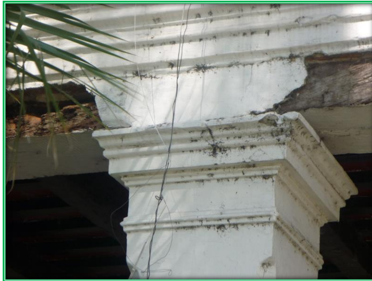
Imagen 37 : Casona del Ingenio San Isidro. Patologías en estructura de madera y revoques. Autor: Efraín Lema
