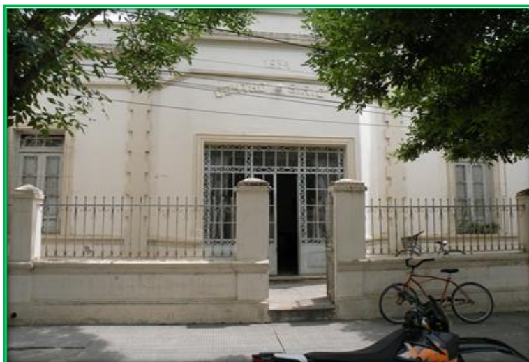
Imagen 40 : Centro Sirio. Patologías en techo, muros y revocos. Autor: Efraín Lema
