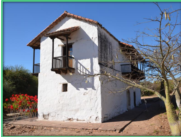
Imagen 36 : Fuerte de Cobos. Patologías en muros y revoques. Autor: Efraín Lema
