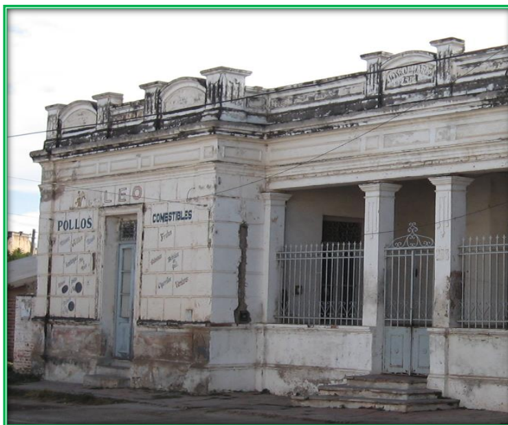
Imagen 39 : Vivienda familiar urbana. Patologías en muros, techos y revoques. Autor: Efraín Lema
