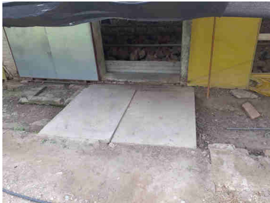
Figura 14. Entrada de unos de los galpones sin pediluvios sanitarios.
