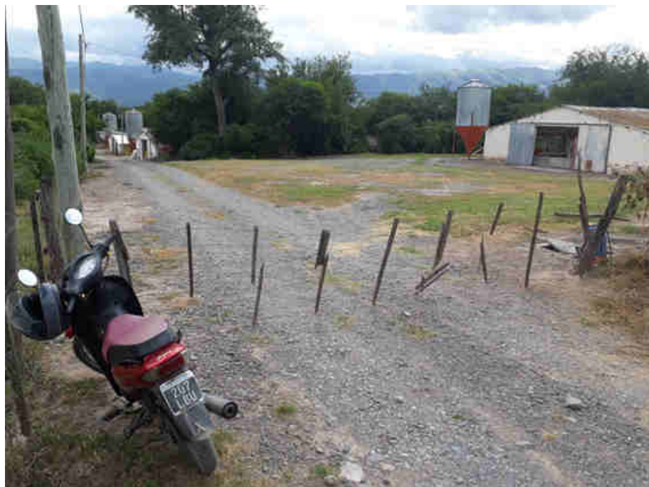
Fig.13. Cerco perimetral en malas condiciones.
