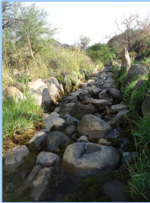
Imagen 7: Deterioro en la última etapa del Canal de conducción (b)
