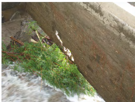
Imagen 10: Desarenador – Deterioro de la Pantalla en la zona de Entrada
