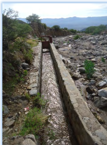
Imagen 30: Compuerta de regulación de caudales (Toma)
