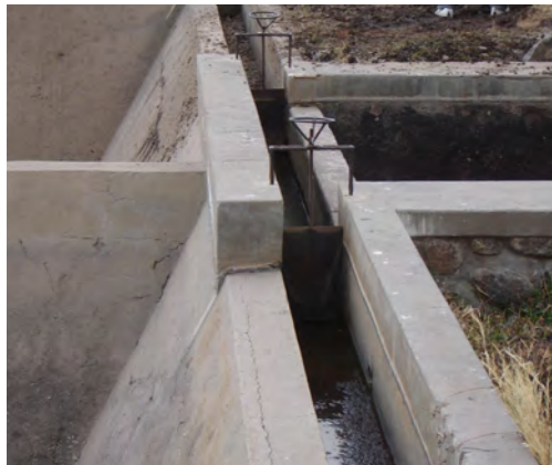
Imagen 24: Detalle entrada Filtros actuales
