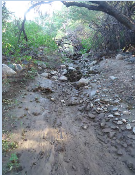
Imagen 6: Deterioro en la última etapa del Canal de conducción (a)
