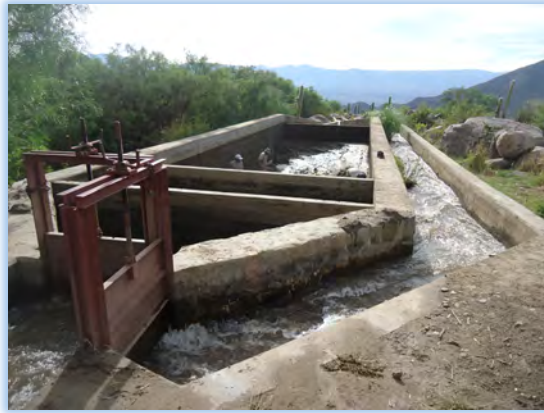
Imagen 8: Desarenador y canal de By-Pass
