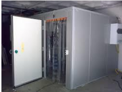
Imagen 3.2: cámara de frio
