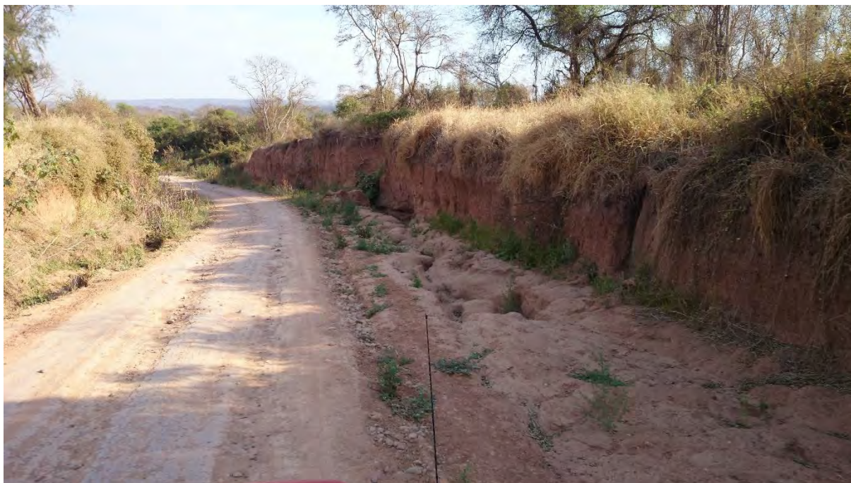
Imagen 8: Grandes socavaciones debido al escurrimiento del agua
