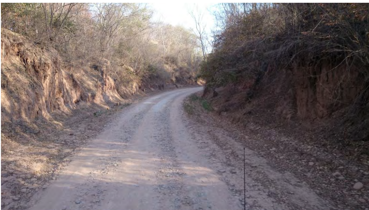
Imagen 7: Prog.3+000 - Ausencia de cunetas
