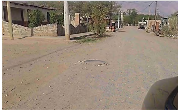
Boca de registro fuera de eje
