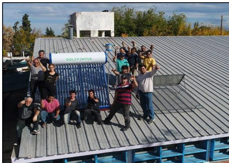
Figura N° 14. Primer calentador solar instalado en uno de los jardines maternos. Fuente: General Alvear Mza, 2017d.
