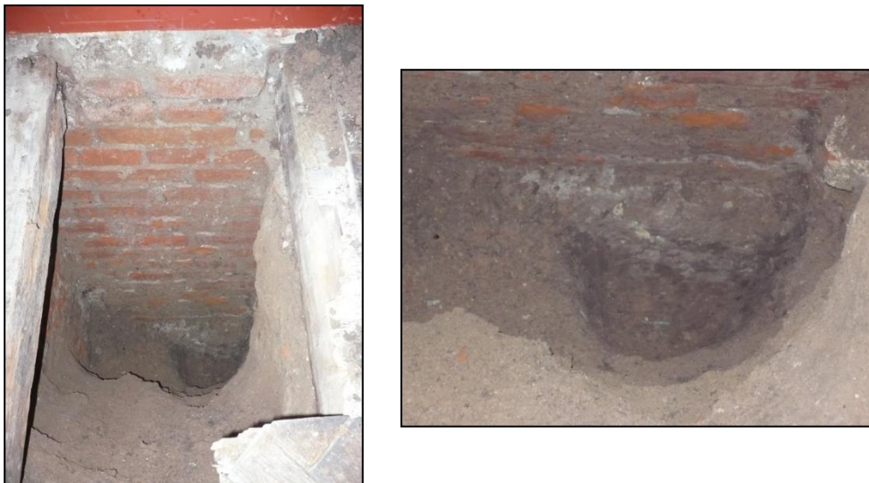
Figura 3.2: Fundaciones de muros de ladrillos macizos en un edificio del centro salteño (ubicado entre Av. Belgrano y Av. Sarmiento)
