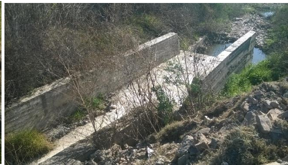
Ilustración 6 - Obra de H°A° en la desembocadura del canal
