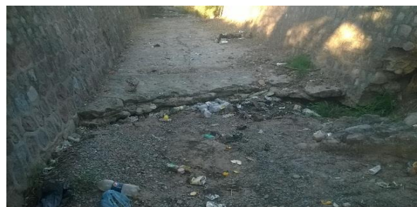
Ilustración 15 - Falla en el fondo del canal
