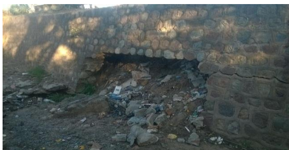
Ilustración 14 - Falla en las paredes del canal
