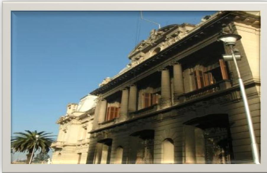
(Imagen 3 -Daños en la Parte Externa – Planta Baja y Primer Piso – Sector del Salon de la Bandera)
