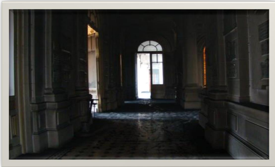
(Imagen 5 -Daños en la Parte Externa del Salon de la Bandera)
