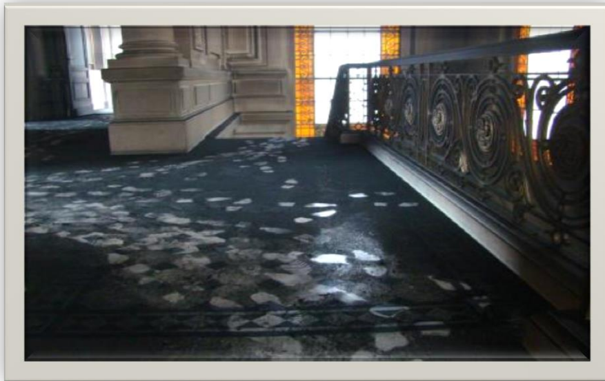
(Imagen 4 -Daños en la Parte Interna – Escalera del Primer Piso – Sector del Salon de la Bandera)
