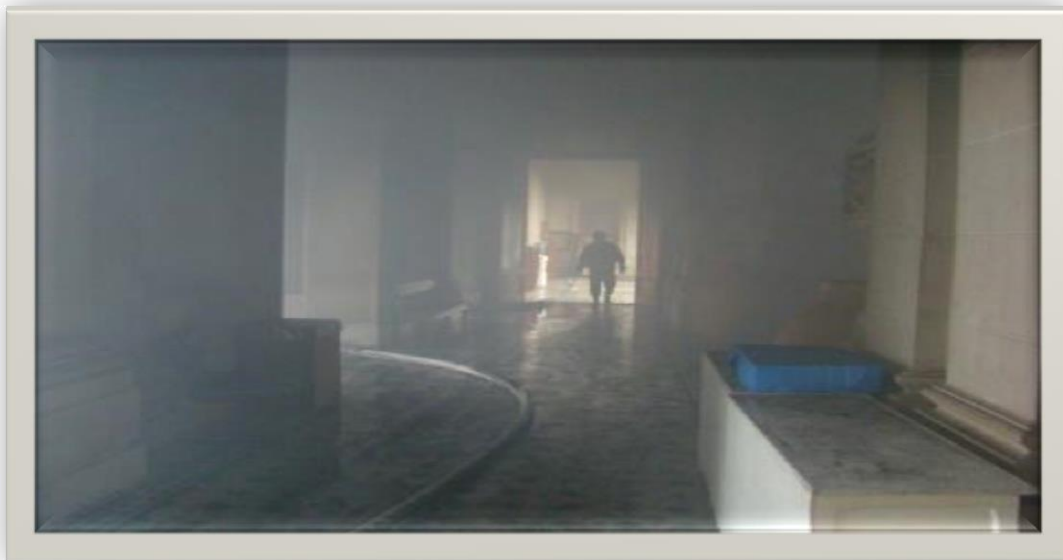
(Imagen 2 -Daños en Planta Baja)
