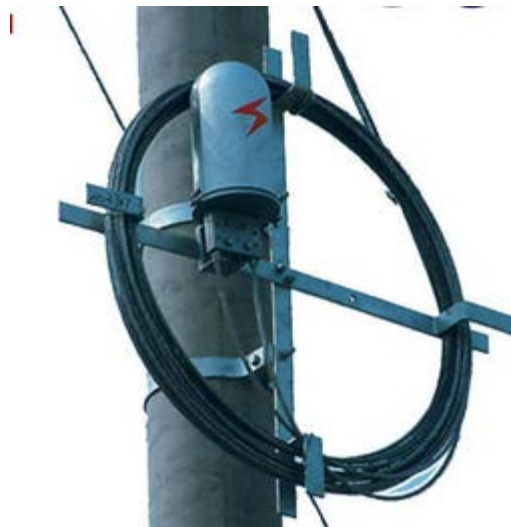
Figura 6.10. Cruz o cruceta de ganancia colocada en poste en vía pública
