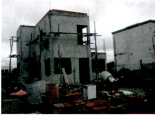
3° INSPECCION AVANCE OBRA: a prototipo vivienda Modelo zona CUYO. Superficie 80 a 120 m 2 .
