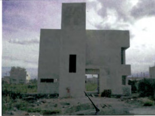
AVANCE DEL 66% apto para 3° desembolso Vivienda unifamiliar con proyecto del cliente. Superficie construida de 120 a 150 m 2
