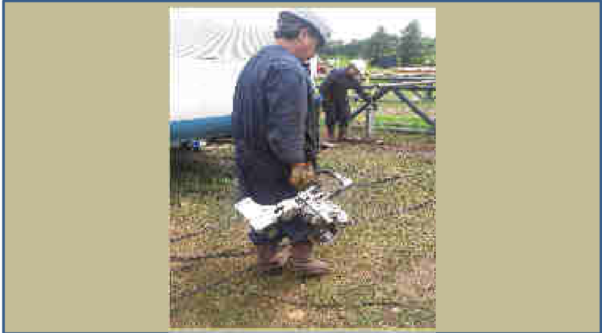
Ensamblado manual de equipo EMI sobre barras.
