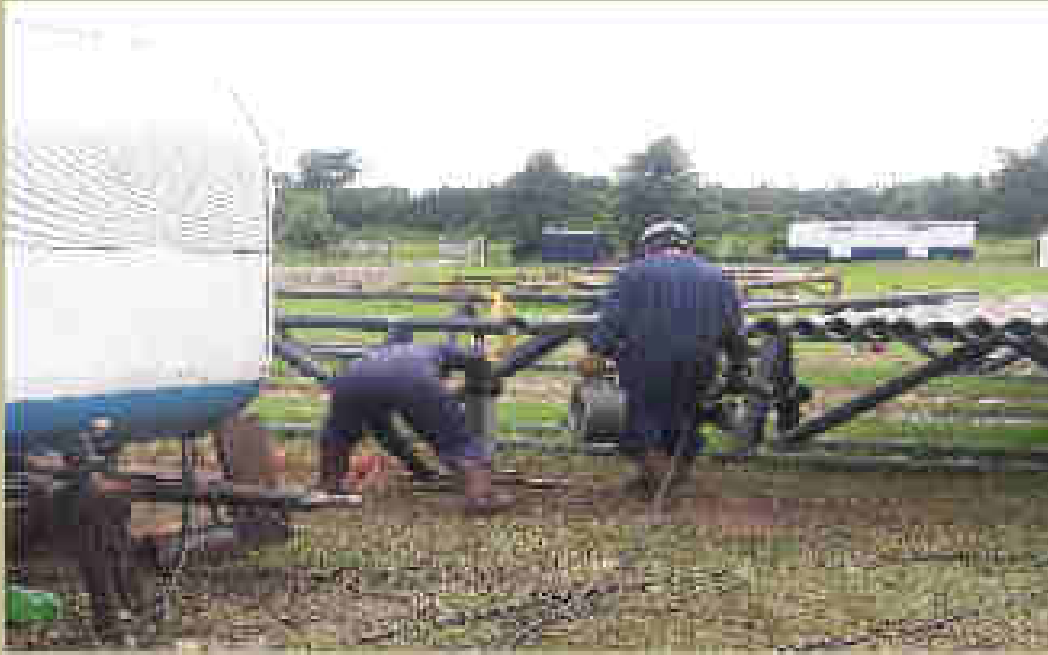
Ensamblado manual de equipo EMI sobre barras.
