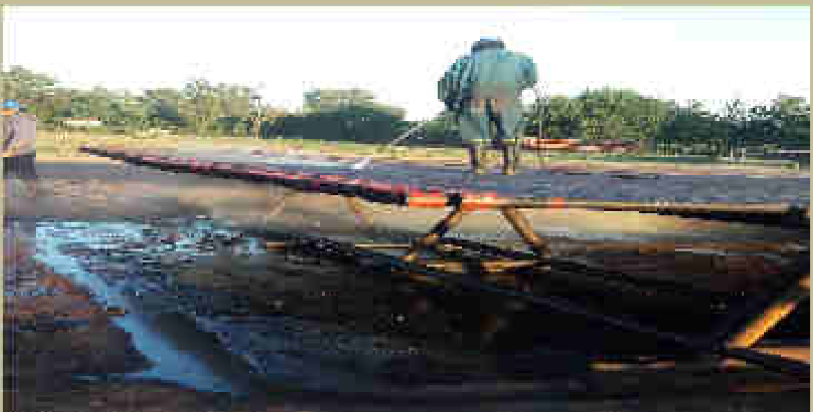
Limpieza con agua caliente, se realiza solamente cuando los tubulares tienen grasa y tierra muy pegada en el cuerpo
