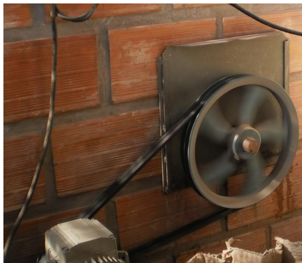
Foto N° 3 polea sin resguardo fijo
