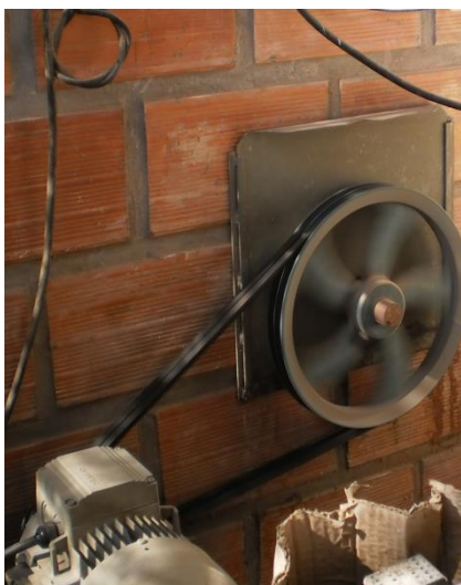
Foto N° 9 Ventiladores parte móvil sin protección
