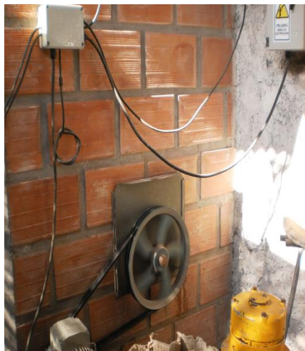
Foto N° 4 Cableado de conexión
