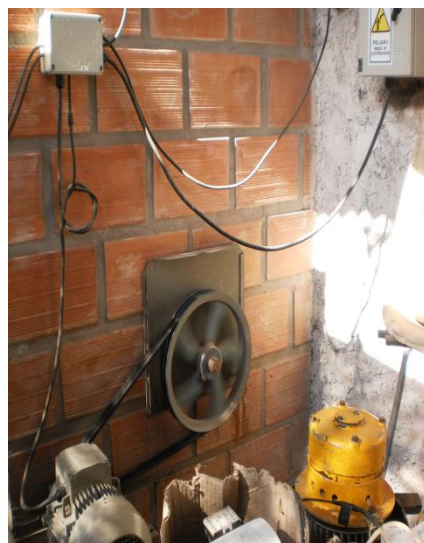
Foto N° 10 Instalación eléctrica inadecuada
