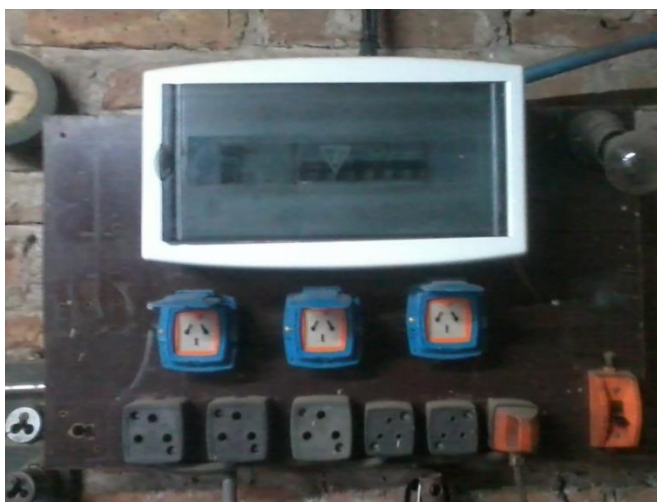
Foto N° 3 Tablero Secundario y tomas
