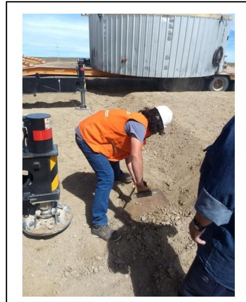
Imagen 57: Hundimiento de bases estabilizadoras por mala compactación de suelo
