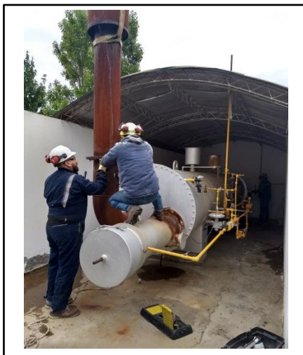
Imagen 82: Desvinculado de chimenea.
