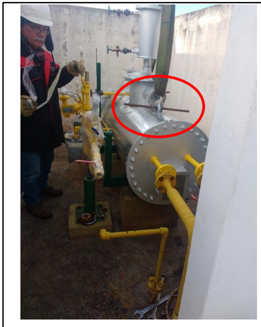
Imagen 77: Falta de perno de grillete
