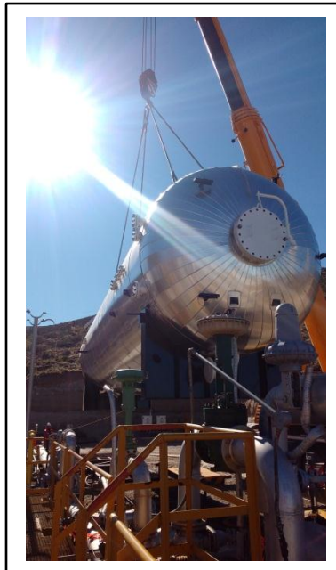
Imagen 65: Movimiento de carga sobre cañerías
