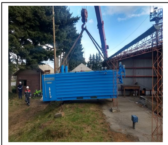
Imagen 62: Choque de eslingas con estructura
