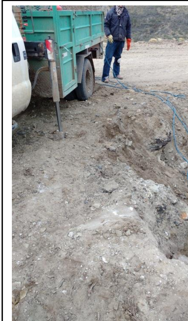
Imagen 98: Falta de colocación de bases adicionales para estabilizadores. Trabajo en cercanía de zanja
