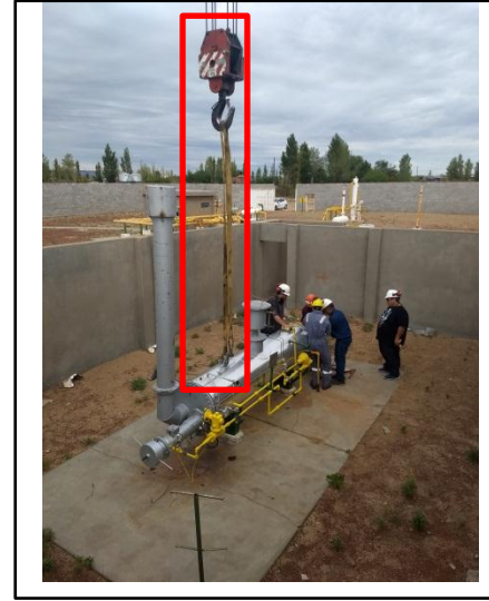
Imagen 87: mal uso de una sola eslinga para guiar la carga y vincular equipo
