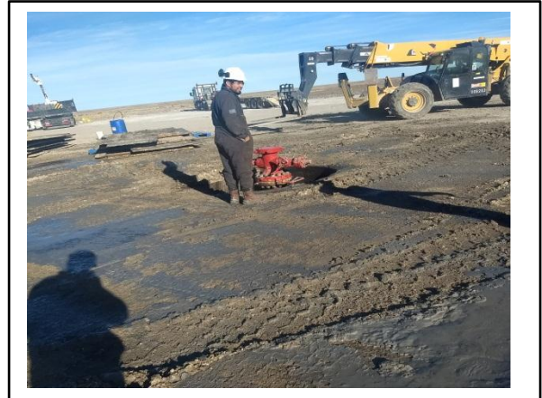
Imagen 109: Lugar de ejecución en malas condiciones
