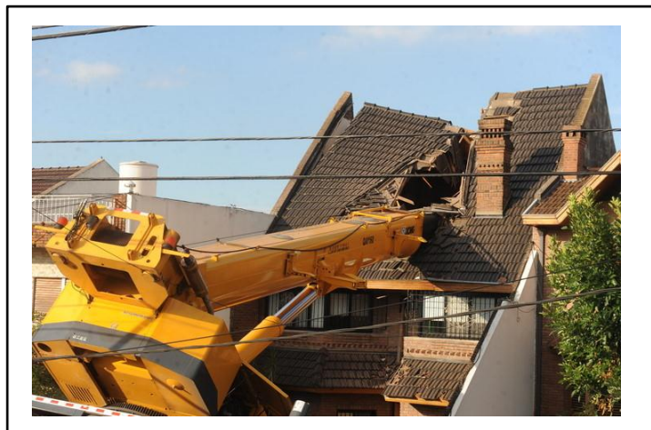
Imagen 2: Caída de grúa sobre casa
