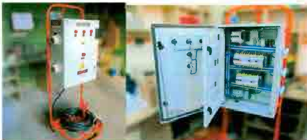
Figura N°49: Tableros para minería Subterránea
