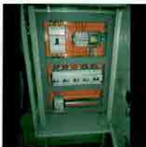
Figura N°51: Interior del Tablero
