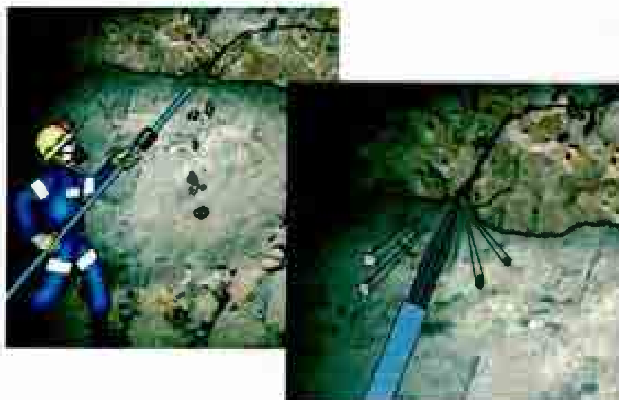
Figura N°23: Acción Crítica de Tojeo
