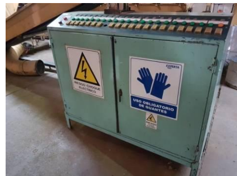
Foto19: tablero seccional de línea de producción con cartelería de seguridad.
