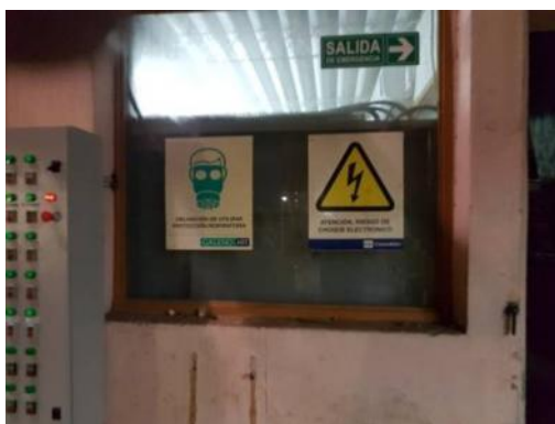
Foto 11: uso obligatorio de protección respiratoria en sector de picking y advertencia de riesgo eléctrico en cuarto de tableros eléctricos.
