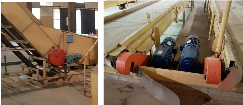
Foto 22: protecciones en distintas cintas de proceso.
