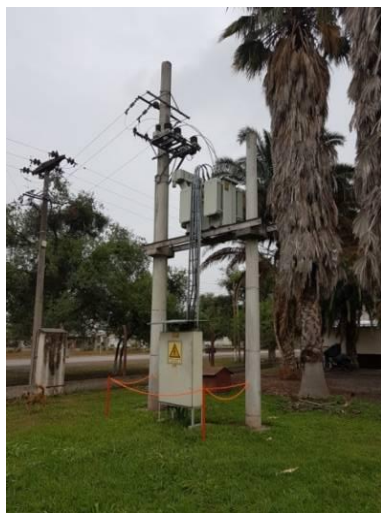
Foto14: ingreso del suministro eléctrico a transformador en el interior del predio.
