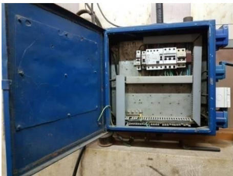
Foto18: tablero seccional: falta contratapa.
