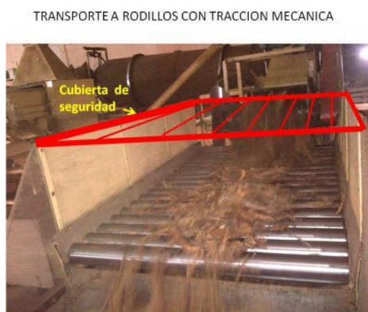
Foto 23: cubierta de seguridad.
