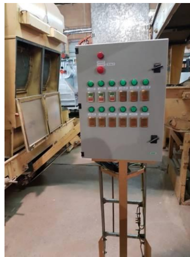
Foto 21: tablero sector cinta de producción con golpe de puño para caso de emergencia.
