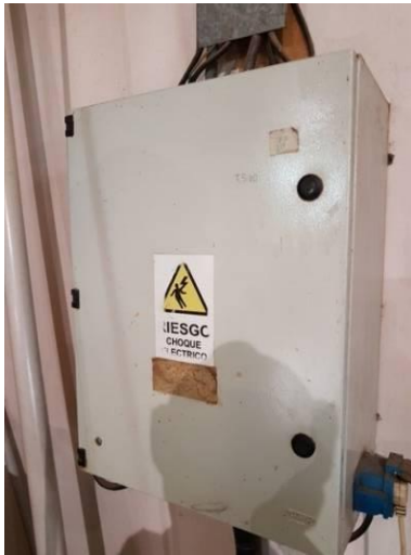
Foto16: tablero seccional señalizado.
