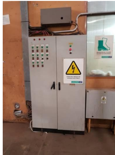
Foto17: tablero seccional de sector prensa.
