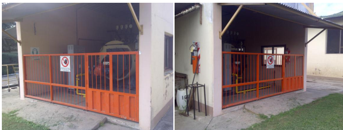
Foto 13: cuarto de cladera señalizado. Con cartelera de uso de EPP auditivo y extintores.
