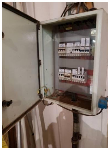
Foto15: tablero seccional en sector proceso.
