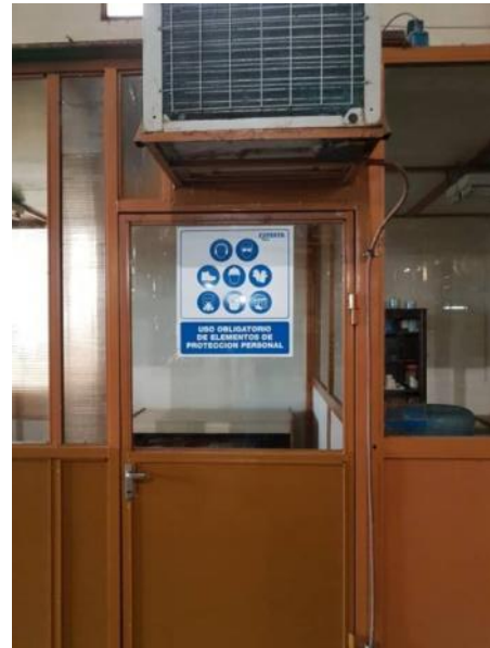
Foto 6: cartelaria en oficinas en sector proceso.
