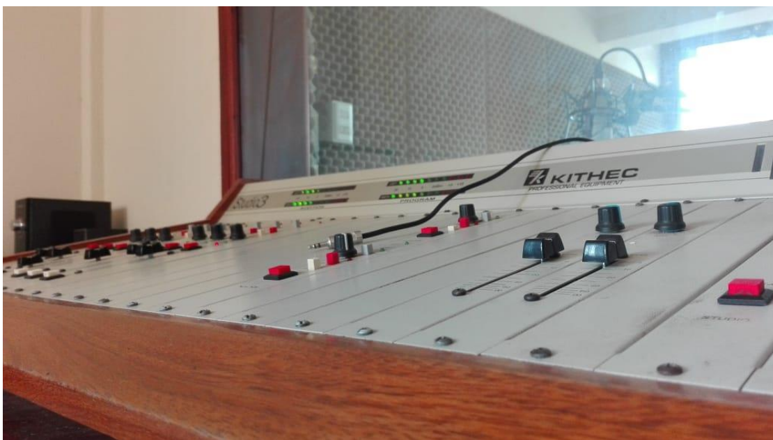
Consola de sala de operación técnica.
