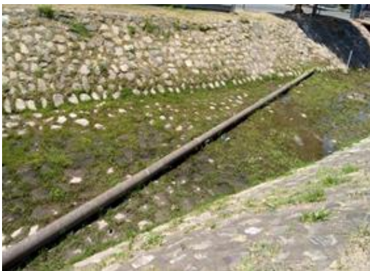
Ilustración 7 - Cañería que atraviesa el canal
