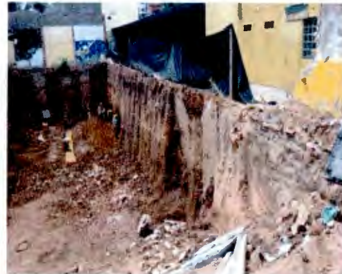
Ilustración A-1 Falta de Puntales
