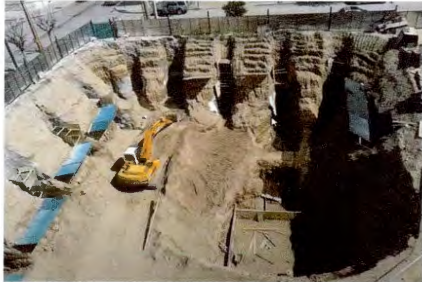
Ilustración A-23 Aplicación del método en Edificio Miralejos Córdoba
