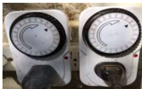
Ilustración 48: Fotografía timer mecánicos de riego
