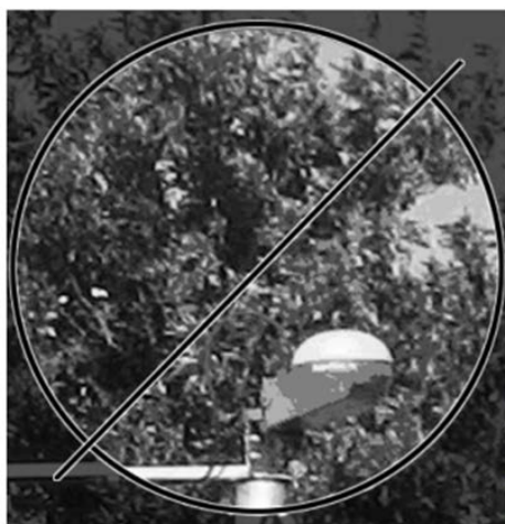
Figura 12-52. Instalación de antena cercana a árboles
