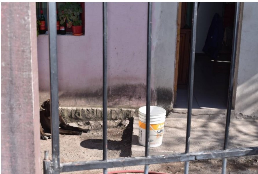
Foto 9-Foto del frente de la edificación vecina. Se puede observar el nivel al que llega el agua en las inundaciones.
