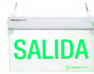
Imagen 59 - Luminaria de emergencia
