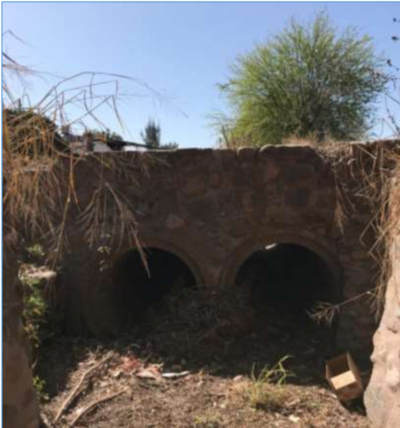
Figura N° 7 Vista de alcantarilla en Camino a Las Moras, son dos tubos de 1m de diámetro.
