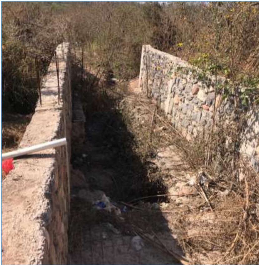
Figura N° 9 Sector final del Canal existente donde no se respetó la construcción de lo establecido en planos del proyecto.
