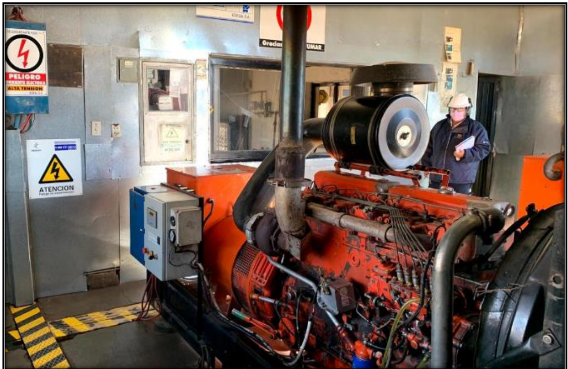
Ilustración 4. Grupo electrógeno central térmica Santa Rosa de los Pastos Grandes
