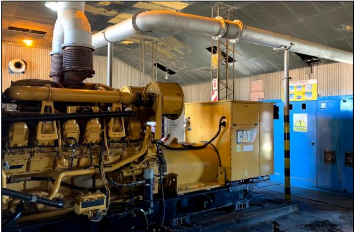
Ilustración 5. Grupo electrógeno central térmica Santa Rosa de los Pastos Grandes
