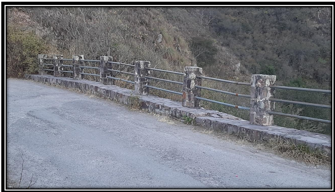
Ilustración 4: Deformación vista en pasamanos.
