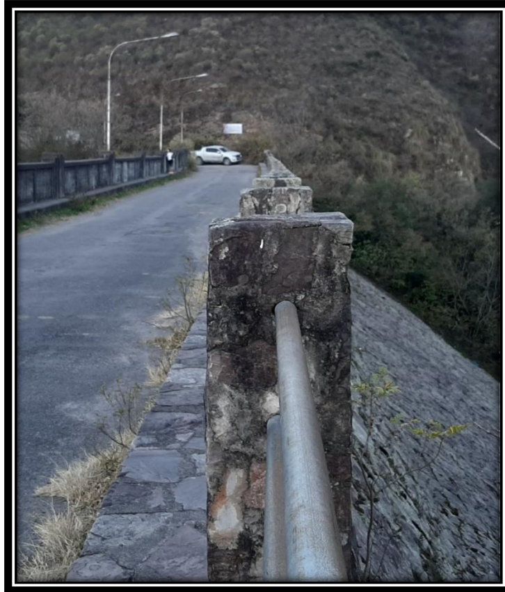
Ilustración 5: Deformación vista sobre coronación.
