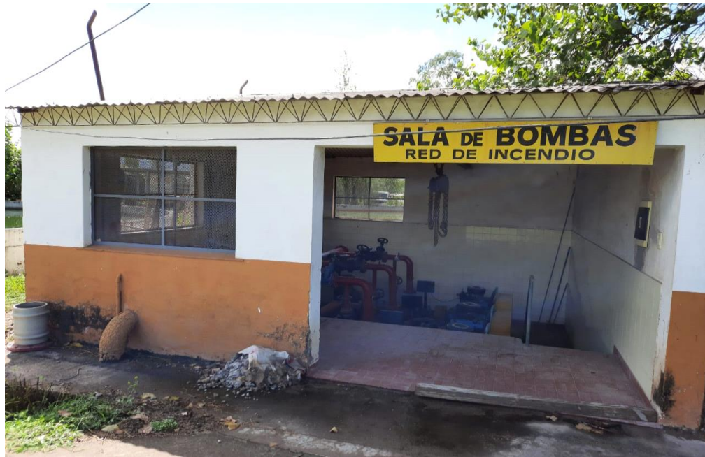
Sala de bombas
