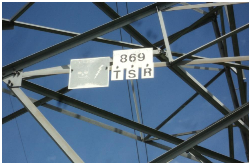
Imagen 29 : Ejemplo de cartelería en mal estado detectada durante recorrida de línea
