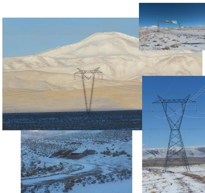
Imagen 3 : Línea de 345 Kv de Internades
