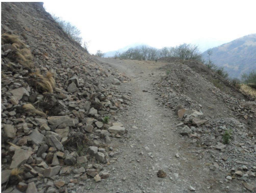
Imagen 52 : Camino disminuido por derrumbe
