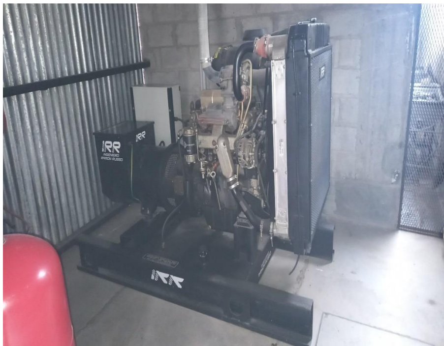
Toma fotográfica N° 47. Grupo electrógeno.
