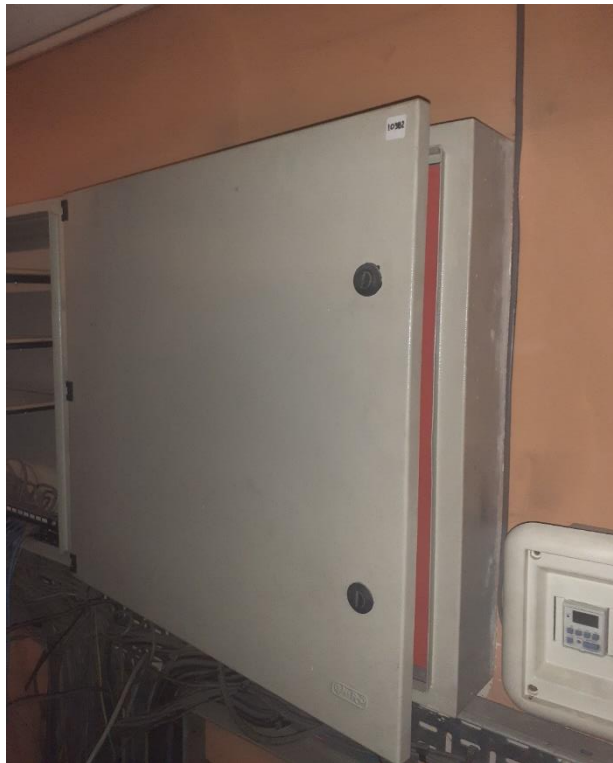
Toma fotográfica N° 05. Tablero eléctrico principal.
