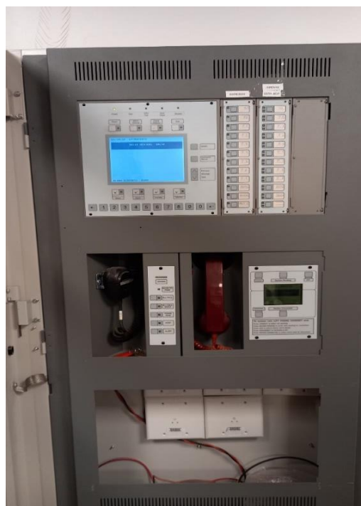
Toma fotográfica N° 41 y N° 42. Sensor de presión y Central de alarma.
