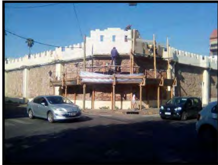
Figura 7. Obra de mantenimiento (calle Santiago del Estero esquina Balcarce ciudad de Salta)
