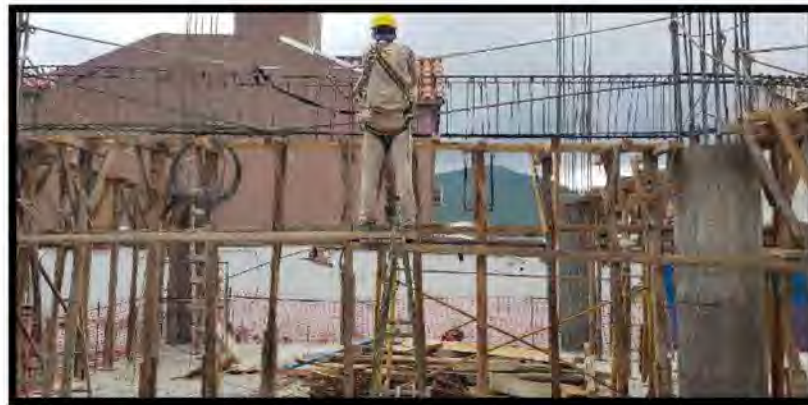
Figura 28. Montantes de caballete metálico
