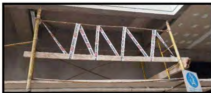
Figura 41. Baranda de madera amarrada con cinta de señalización de peligro
