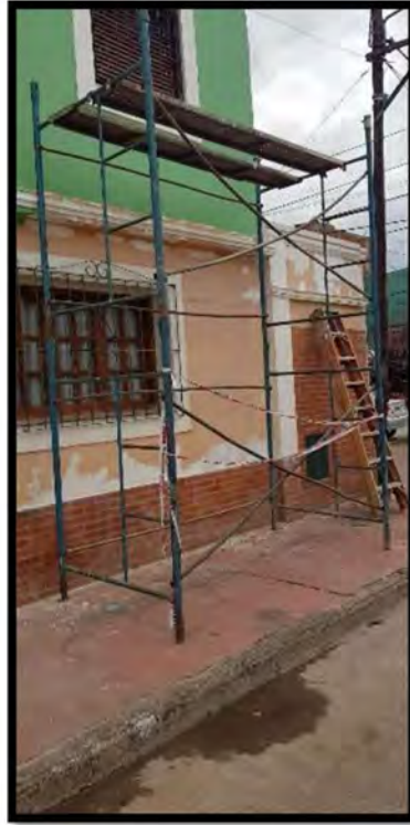
Figura 43. Andamio tubular típico con armado con las escaleras apartadas de la fachada
