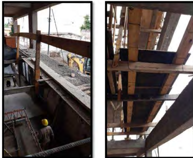
Figura 8. Obra en construcción de la empresa RAC (Pasaje Zorrilla Ciudad de Salta)
