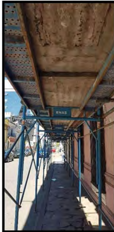
Figura 24. Plataforma mixta de módulos metálicos antideslizantes y chapa acanalada deformada.
