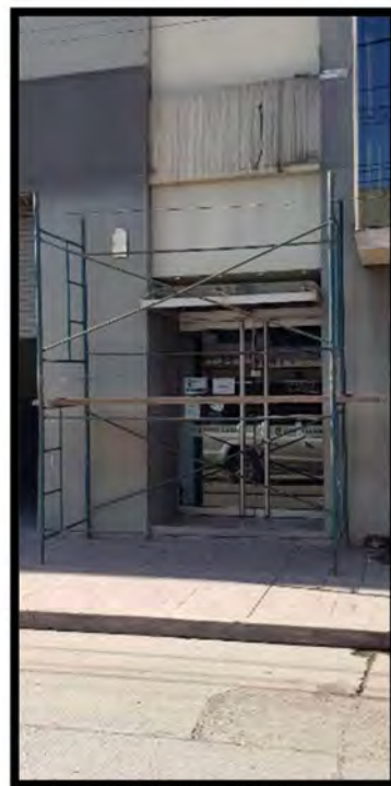
Figura 50. Sistema de andamio tubular metálico
