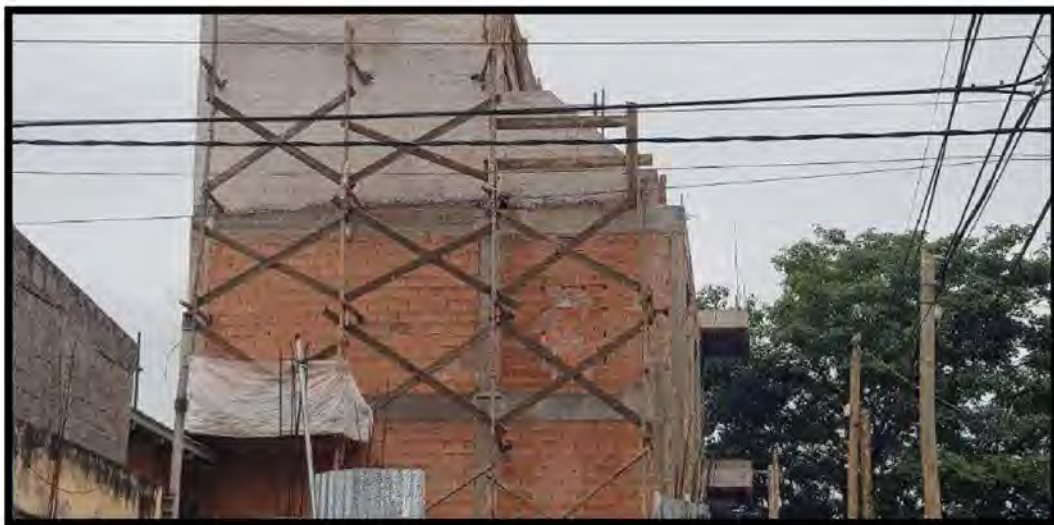
Figura 56. Andamio de madera con diagonales
