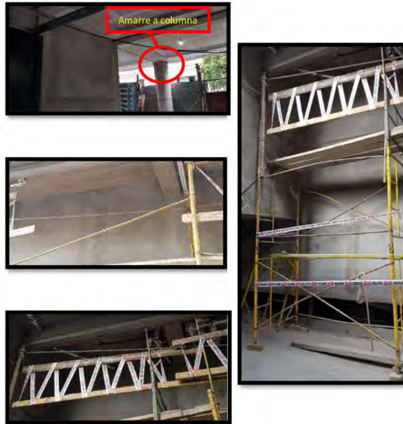
Figura 39. Secuencia de fotos que muestra la sujeción con soga a columna de hormigón armado
