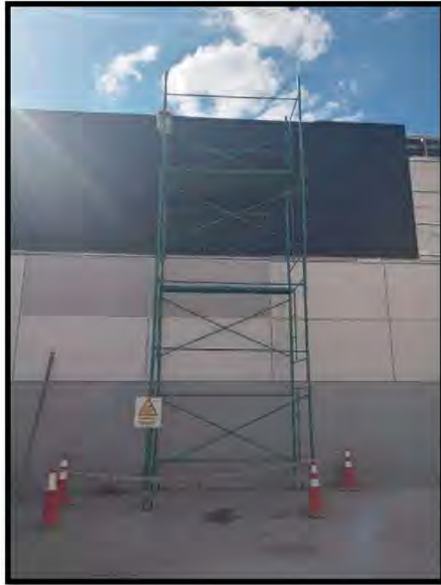
Figura 67. Andamio metálico de cuatro cuerpos en altura.
