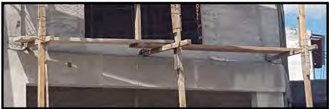
Figura 75. Plataforma de andamio de madera.
