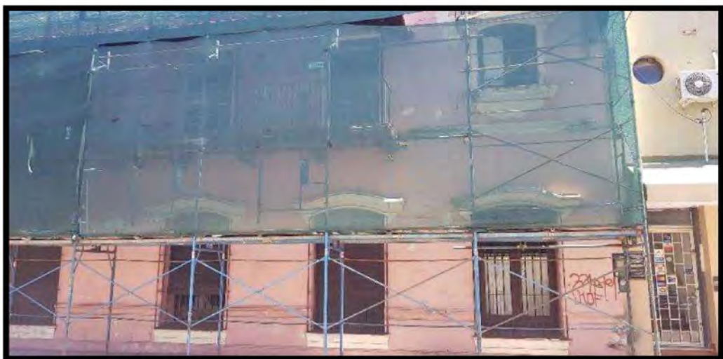
Figura 22. Andamio modular múltiple
