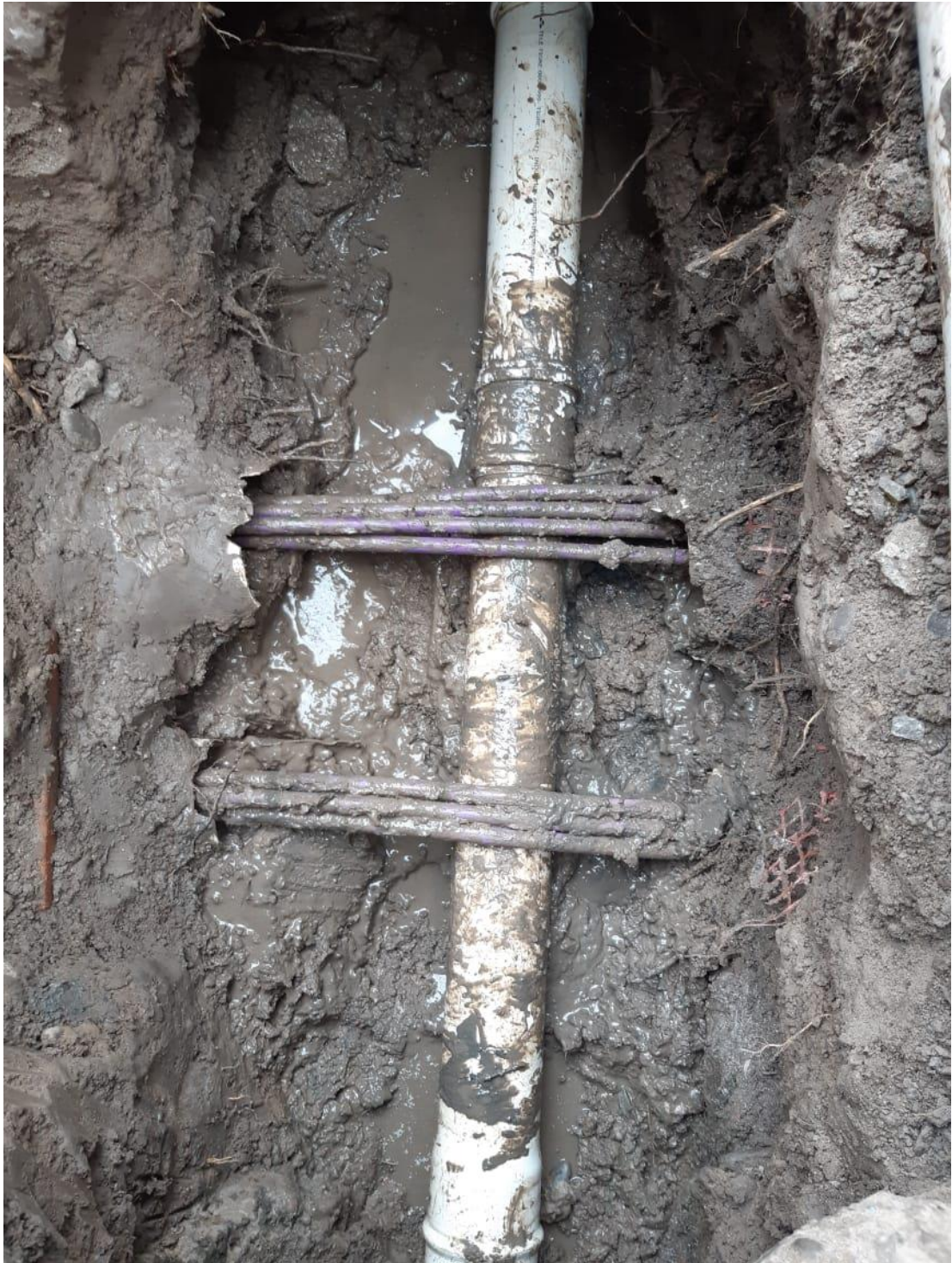
Ilustración 22: Interferencia en excavación de cableado eléctrico 25
