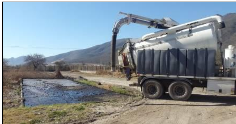
Ilustración 32. Desagote de cisterna de camión en planta depuradora 44
