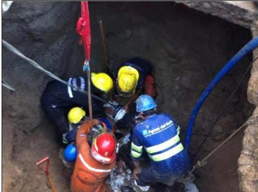
Ilustración 23: Operario del sector cloacas atrapado en un pozo (Cafayate – Año: 2015) 26
