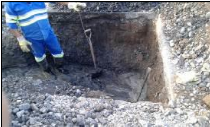
Ilustración 13. Presencia de líquidos cloacales en zanja abierta. 16
