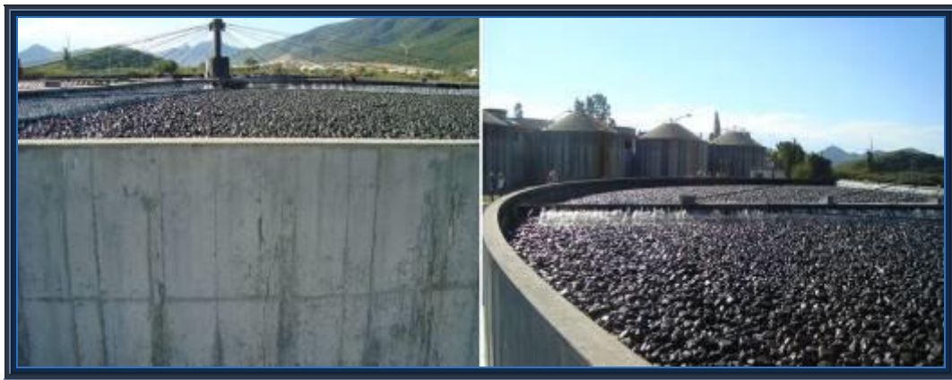
Ilustración 4. Planta depuradora o sistema de tratamiento de lechos percoladores 4
