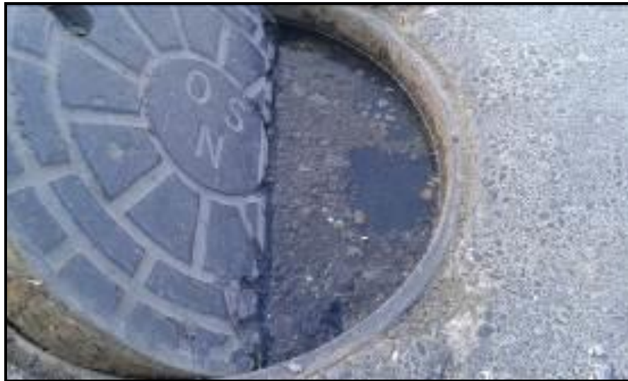
Ilustración 10. Líquido cloacal presente en las bocas de inspección 13
