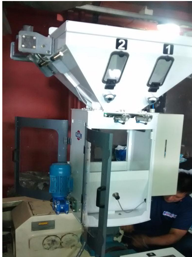
Imagen XXXI- Instalacion de Dosificador
