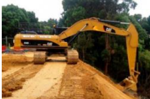
Ilustración 22. Retroexcavadora en acción. Fuente: CAT.
