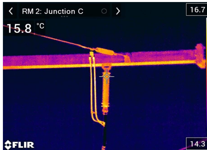
Ilustración 31: Imagen térmica con medición de temperatura desde una distancia segura
