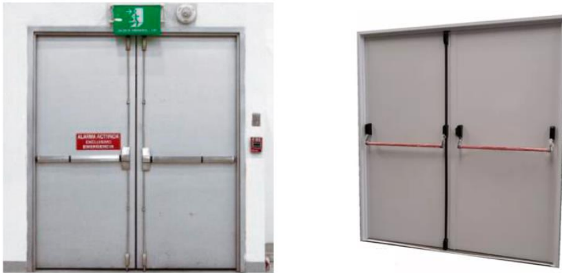
IV – Fig. N°1: Puertas de Emergencia.
