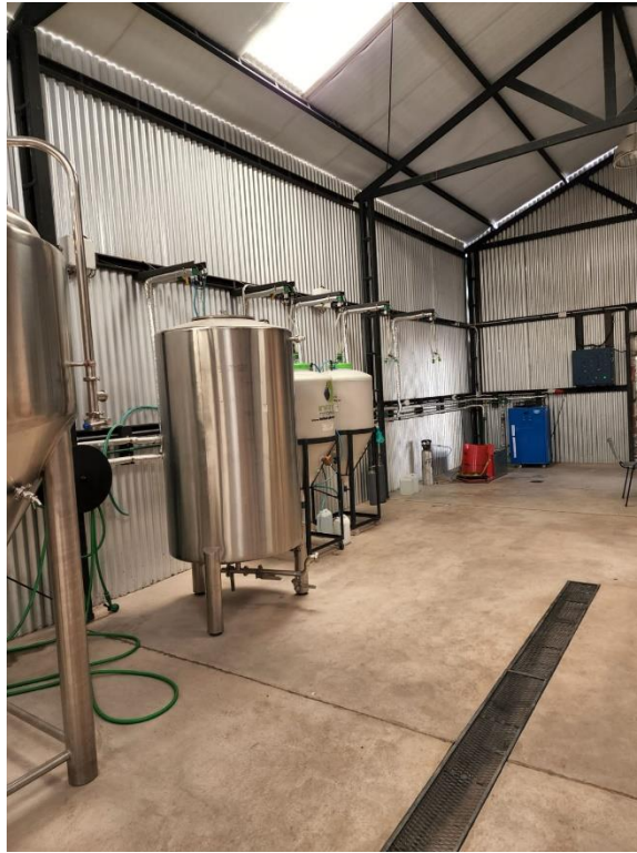
Ilustración 79. Tanque de Almacenamiento Agua de Proceso
