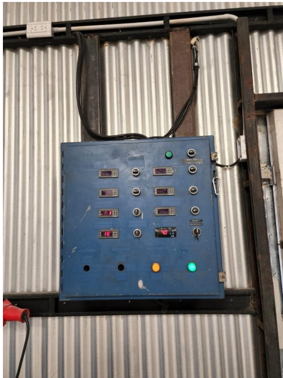
Ilustración 80. Tablero de Control
