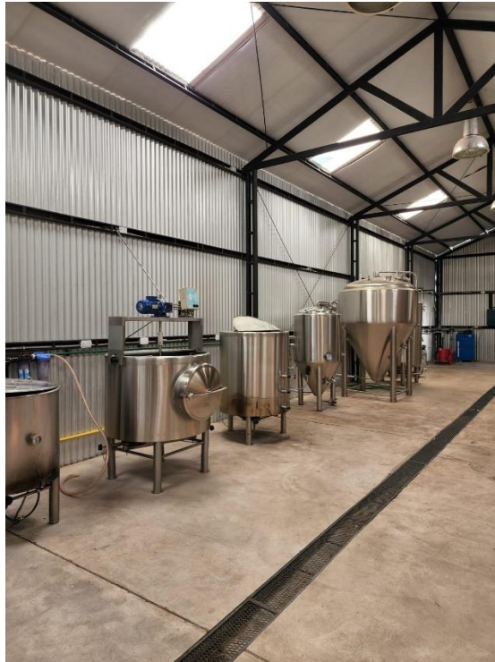
Ilustración 75. Equipos para las Diferentes Etapas del Proceso
