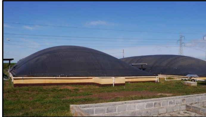
Figura 8- Biodigestor de laguna cubierta
