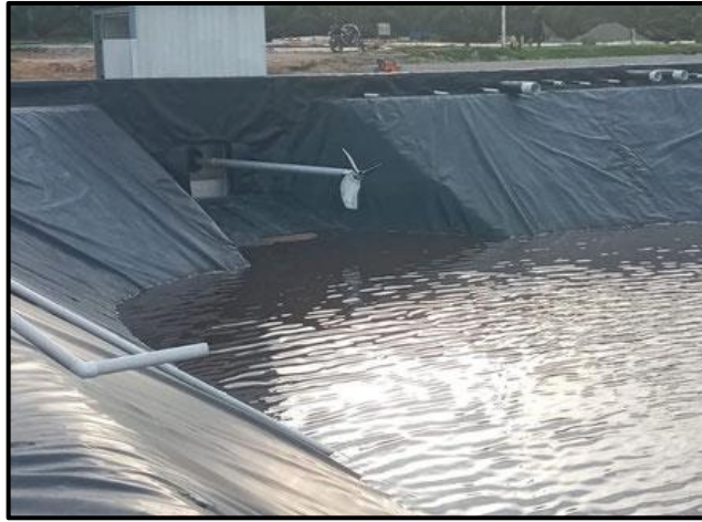
Figura 24 - Agitadores instalados en biodigestor primer ejemplo
