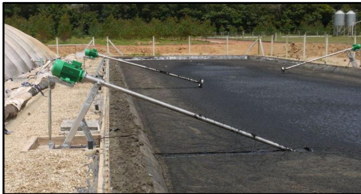
Figura 25 - Agitadores instalados en biodigestor segundo ejemplo
