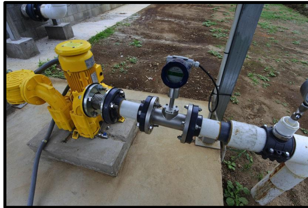
Figura 23 - Medidor de caudal de biogás
