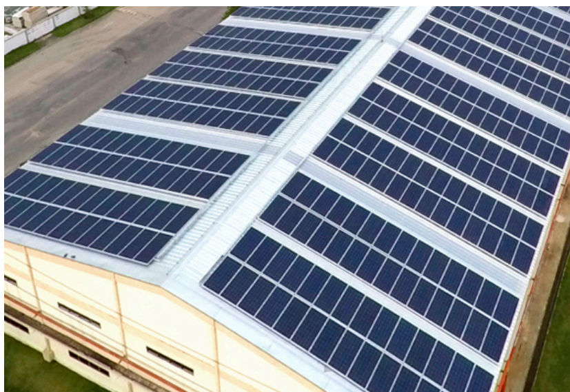
Figura 21. Paneles solares sobre cubierta de una nave industrial.
