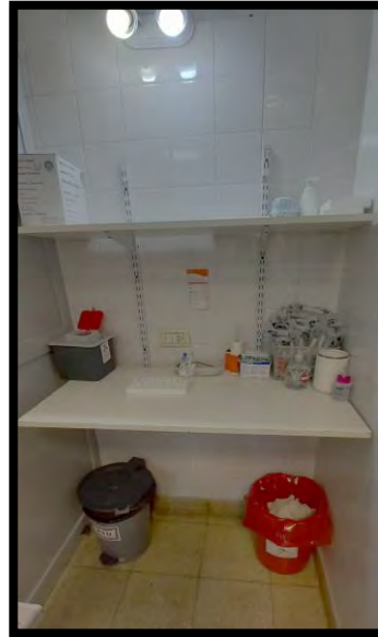
Fig. 5.5 Mesada de box para extracción.
