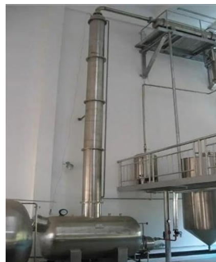
Ilustración 4.9: Torre de destilación (TD-301)
